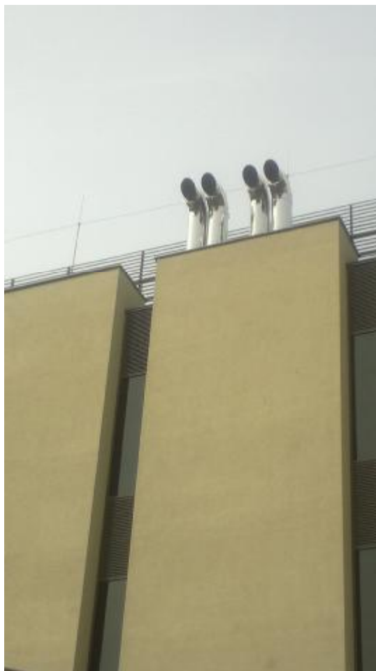
System spalinowy 4 x medi E i D 350, H – 20 m agregaty prądotwórcze
